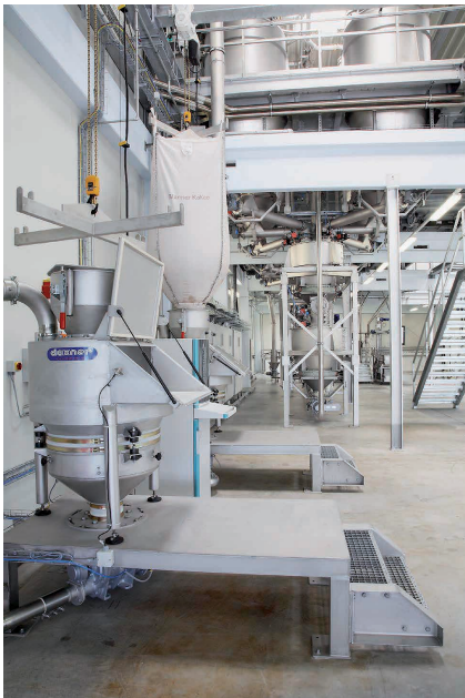
Aufgabestation für die Produktaufgabe von Sackwaren und Big-Bags sowie die pneumatische Förderung in den zugehörigen Tagessilo
