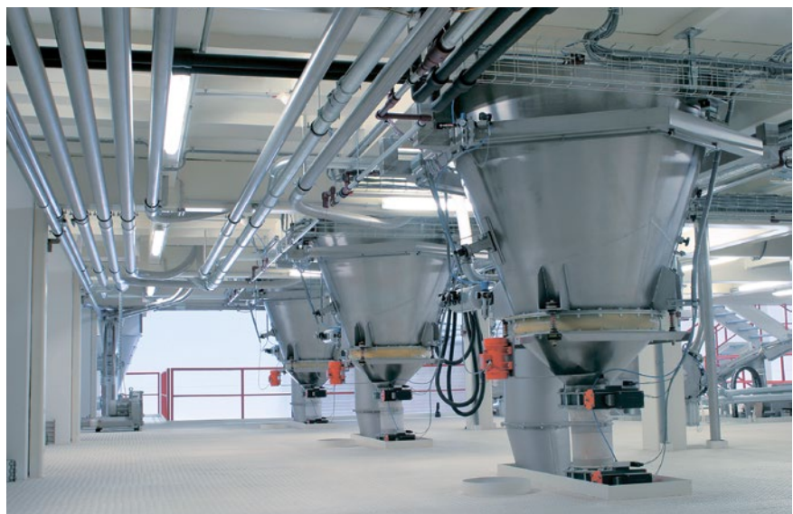
Behälterwaagen mit Vibroaustragböden
