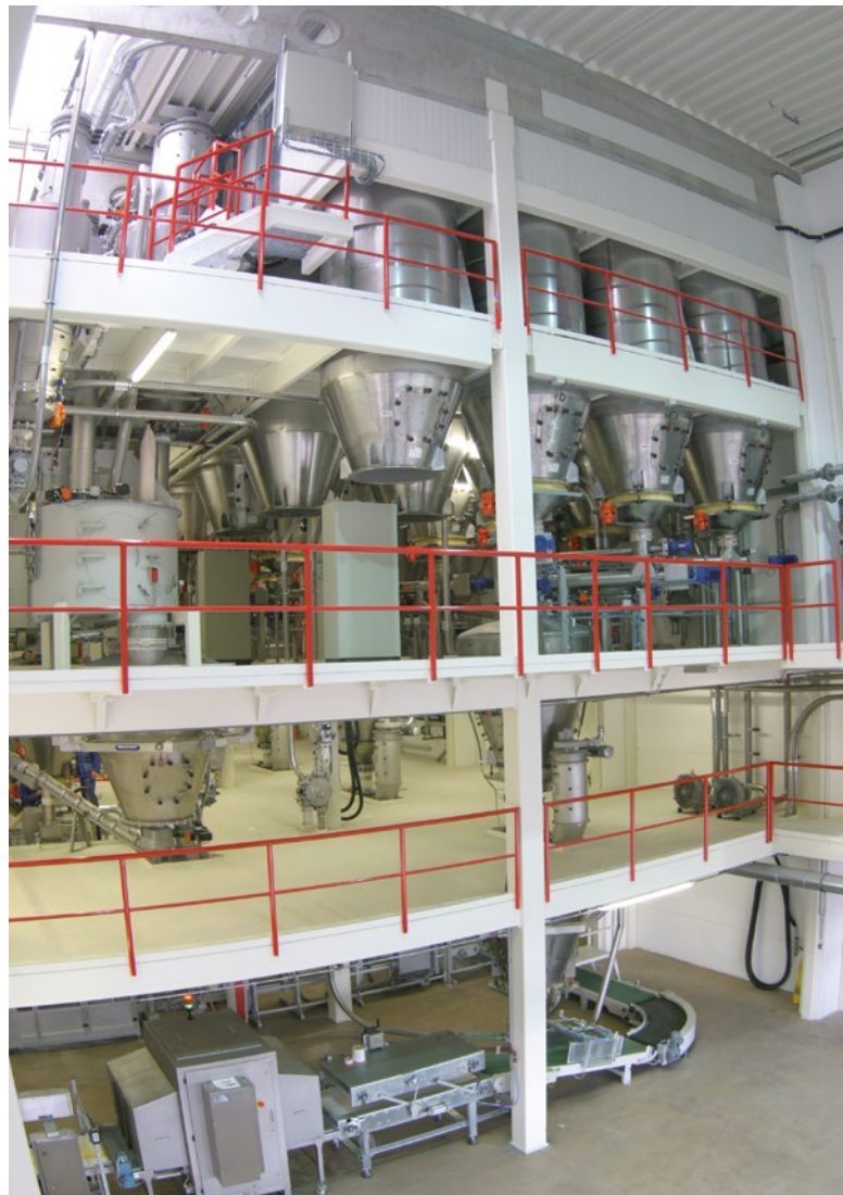
Multipurpose-Anlage: Ansicht der Gesamtanlage Tagessilos-Chargenmischer-Absackanlage
