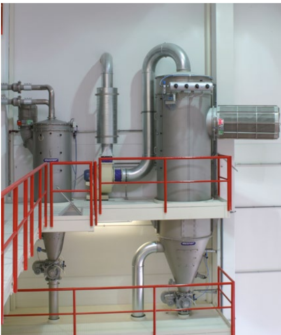
Zentrale Staubsauganlage Ex-Druckentlastung mit Q-Rohr Zentralaspiration mit Düsenfilter
