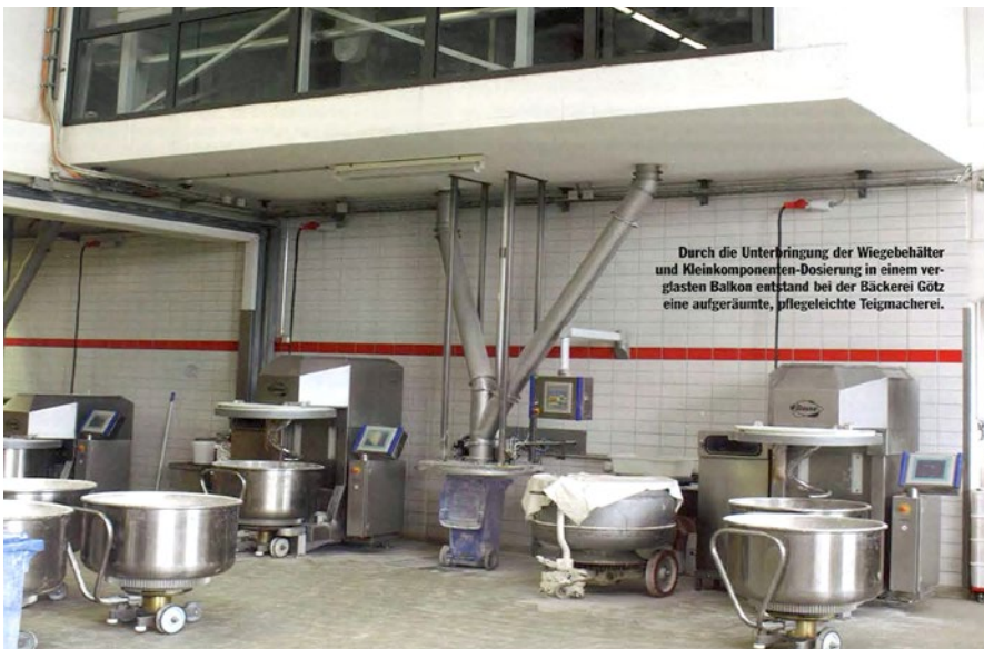
Durch die Unterbringung der Wiegebehälter und Kleinkomponenten-Dosierung in einem verglasten Balkon entstand bei der Bäckerei Götz eine aufgeräumte, pflegeleichte Teigmacherei.
