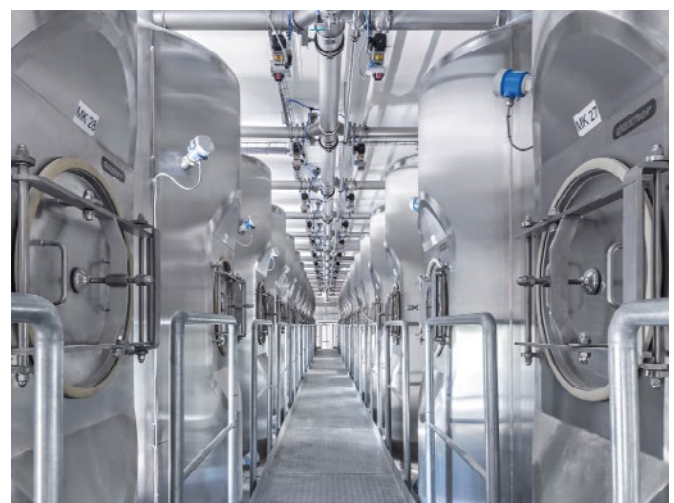
Die Mittelkomponenten werden in Tagesbehältern gelagert und über mobile Big-Bag Sackaufgabestationen befüllt.
