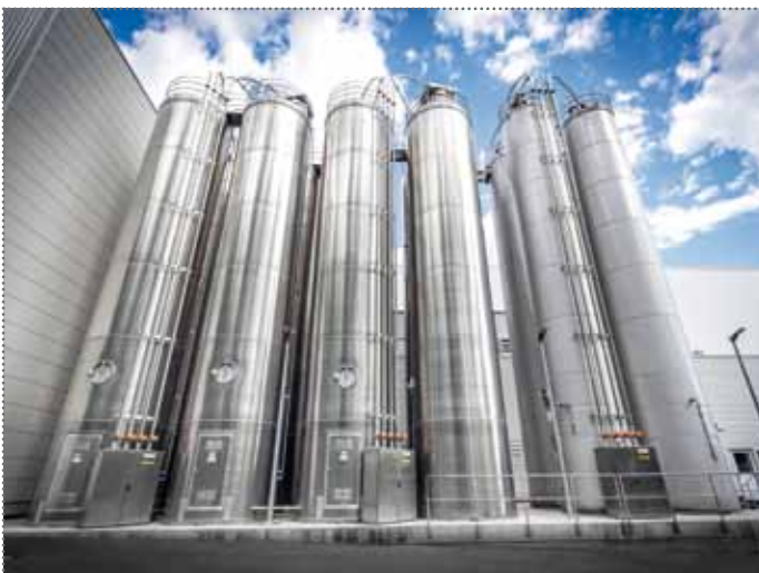
Die Hauptkomponenten werden in Außensilos gelagert und pneumatisch den Mischlinien zugeführt.
