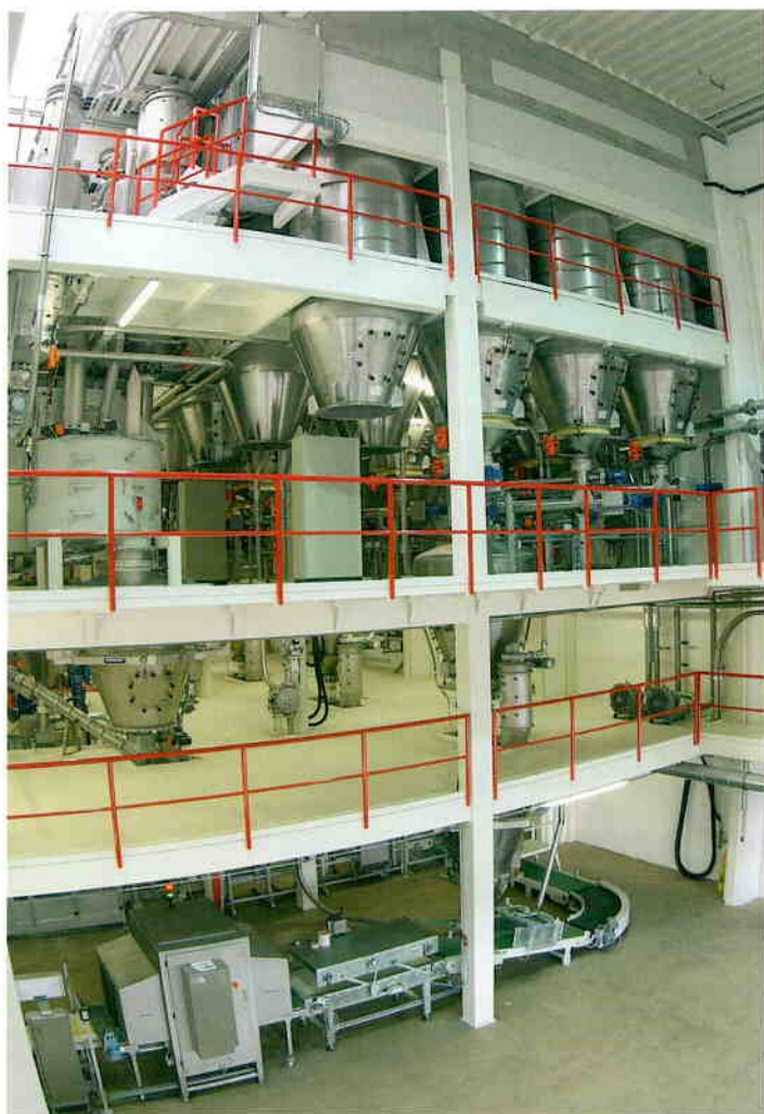
Abb. 1: Ansicht der Anlage mit Tagessilos, Chargenmischer und Absackung
