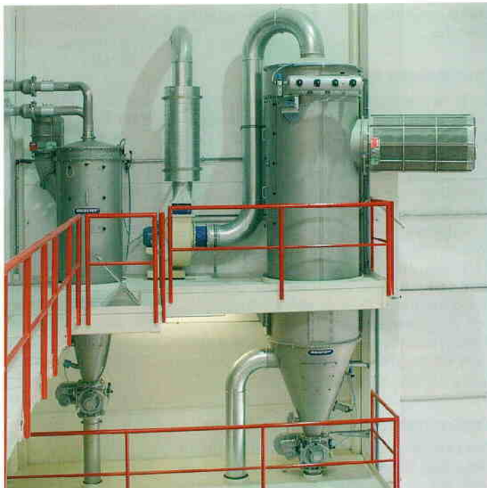
Abb. 4: Zentrale Staubsauganlage für gleichzeitigen Betrieb von sechs Absaugstellen mit Explosionsdruckentlastung und Q-Rohr sowie Zentralaspiration mit Düsenfilter Bildnachweis: Ing. Johann Daxner GmbH, Wels/Oberösterreich
