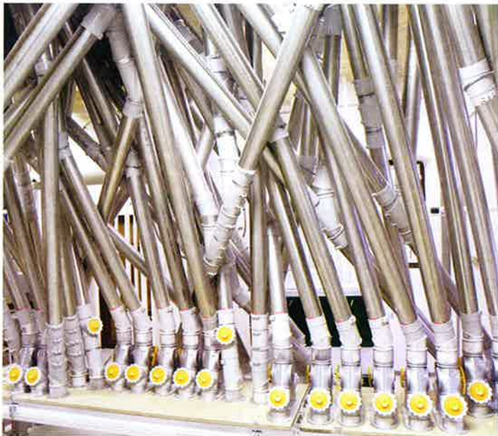
Abb. 5: Für den Rohrbau entwickelte Daxner eine Kombination aus Sallhofer-Baukastensystem mit Edelstahlrohren, welche den hohen Hygieneanforderungen standhält.
