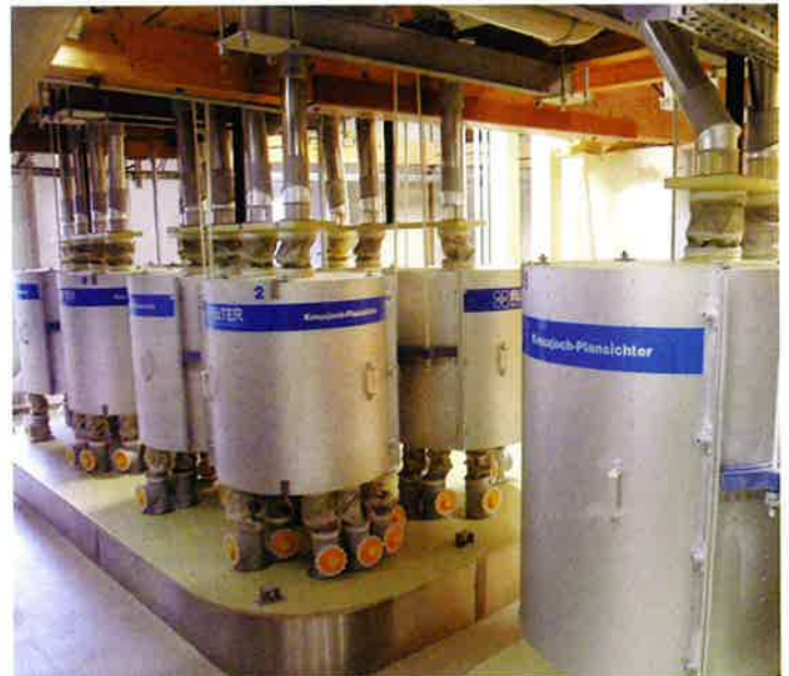
Abb. 4: Kreuzjoch-Plansichter mit geringer Gebäudebelastung wurden 400 mm höher platziert, um ein ideales Gefälle zu erzielen.
