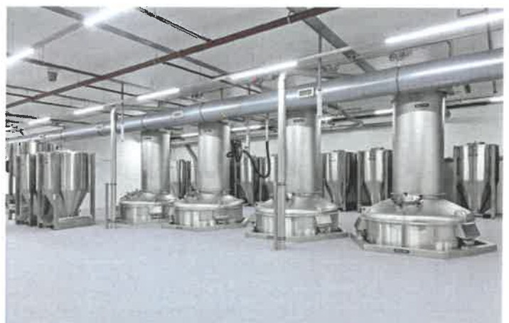
Abb. 3: 10000-l-Behälterwaagen über Hochleistungs-Mischlinien
