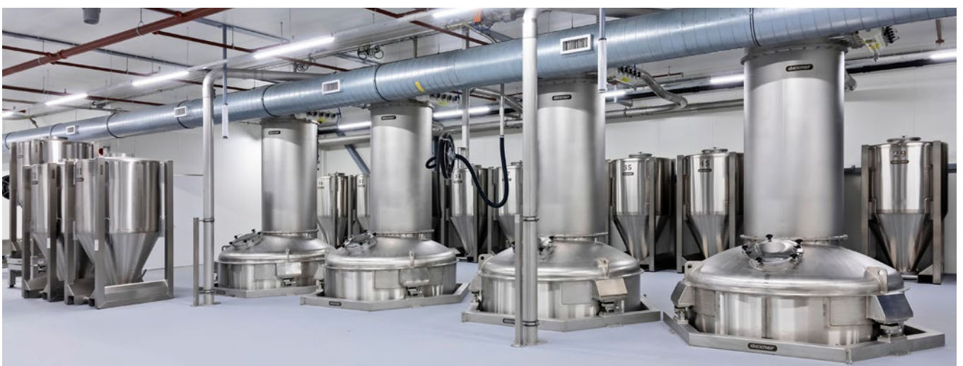
10.000 l Behälterwaagen über den High-Performance-Mischlinien.
