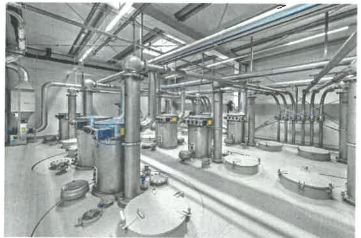
Abb. 2: Silokopfraum mit Filter und Reinluft-Sammelleitung
