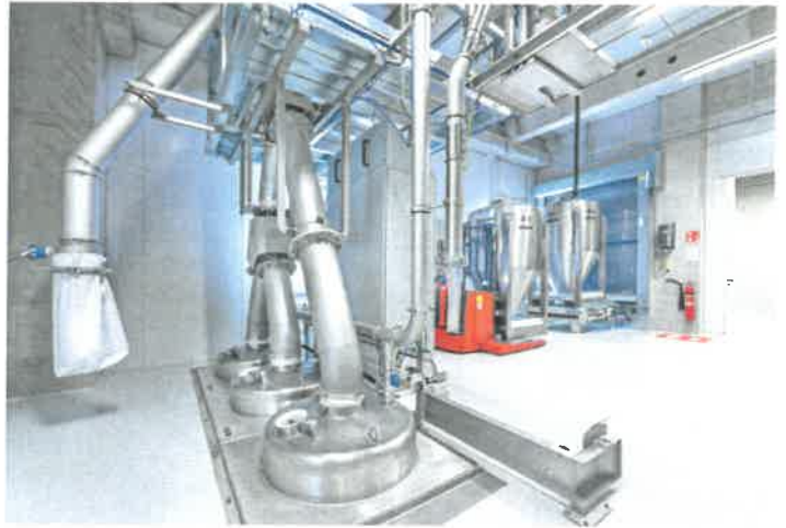
Abb. 7: Pufferbehälter für Absackung
