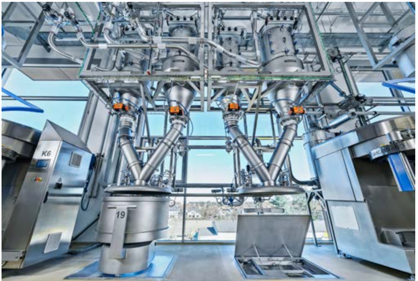
Zentrale Mehl- und Komponentenverwiegestation mit Bodenwaage
