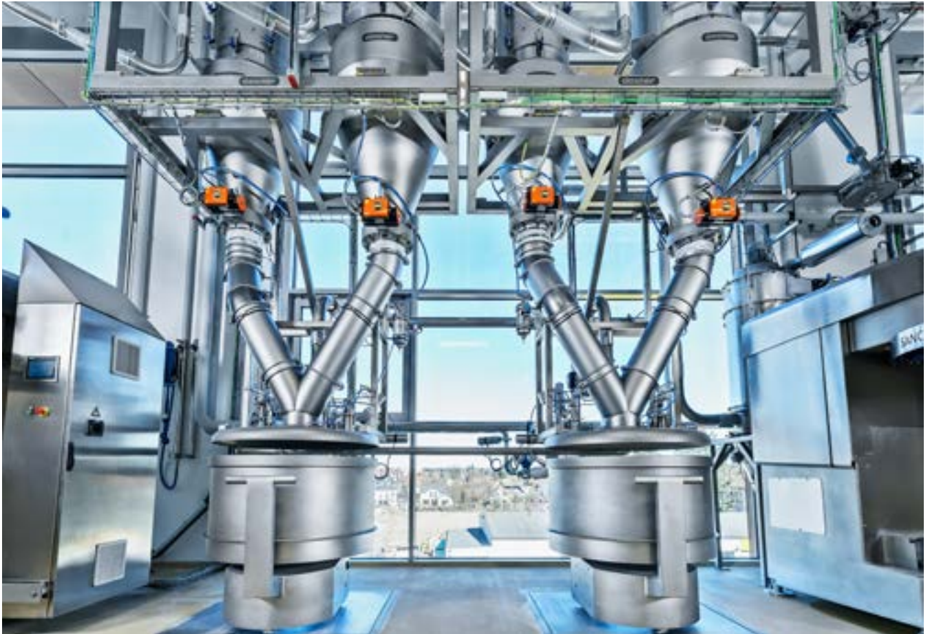
Zentrale Mehl- und Komponentenverwiegestation
