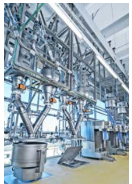
Zentrale Mehl- und Komponentenverwiegestation mit Knetsystemen
