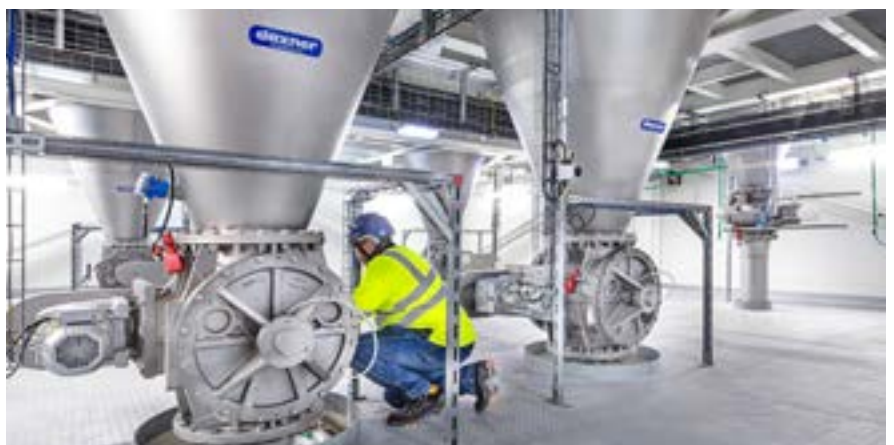
Totalabscheider mit Zellenradschleuse
