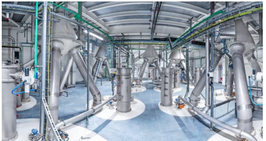
Rohstoffbeschickung der Großkomponenten-Silos
